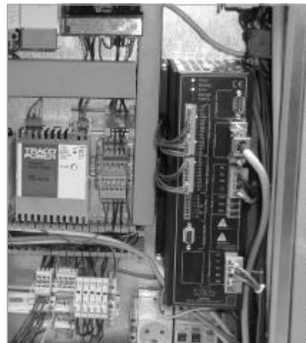
AMC20 AC Servocontrolleren i styreskabet
