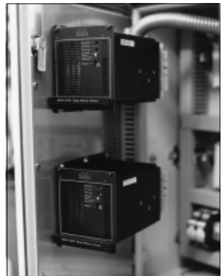
Driverne SMD15B monteret på lågen i styreskabet.
