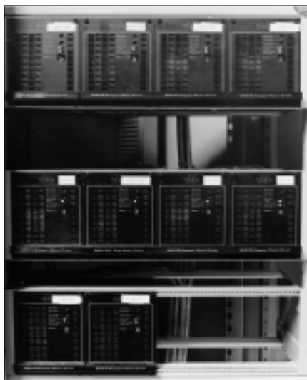
Driverne til svejserobotterne monteret i rack i styreskabet
