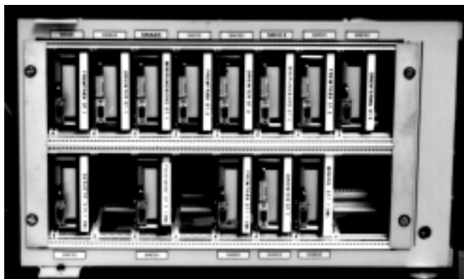
JVL Stepmotorcontrollere monteret i 19" rack i et styreskab
